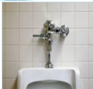
Flushing Urinals ( \leq 0.5 gpf)
