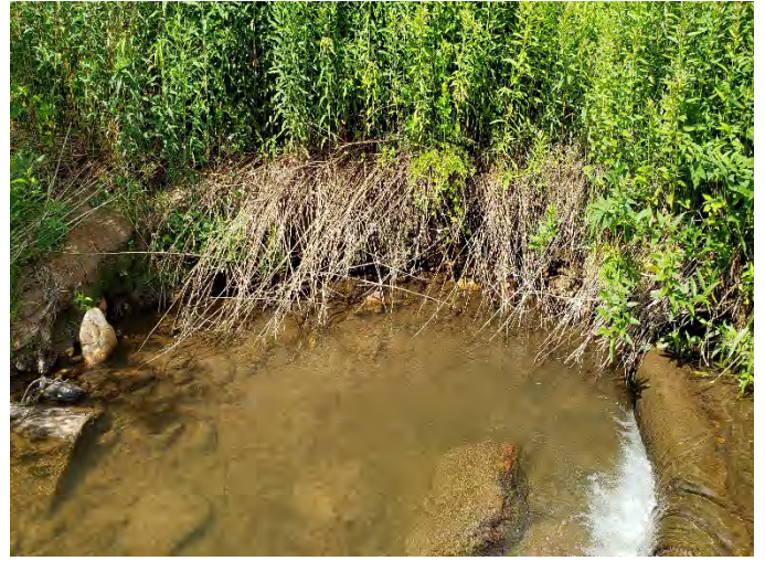
Vile Creek R2: STA 121+00 - 121+25 - Left Bank Erosion 5-23-2021
