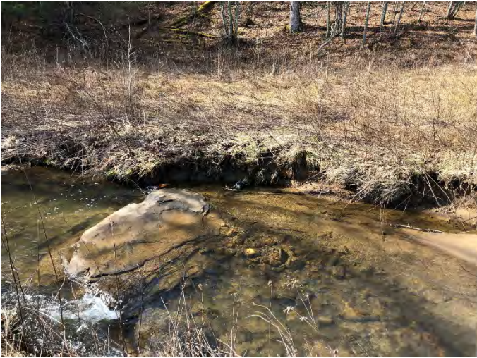
Vile Creek R2: STA 123+00 – Rock Sill Failure 3-17-2021
