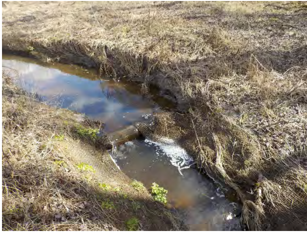
SPA3- Loose log structure- UT1 @ Sta. 17+60
