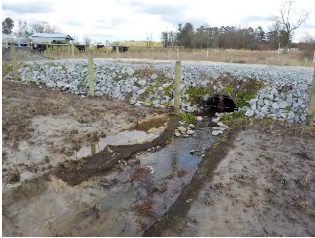
SPA1- Bank Erosion- UT1 @ Sta. 14+90
