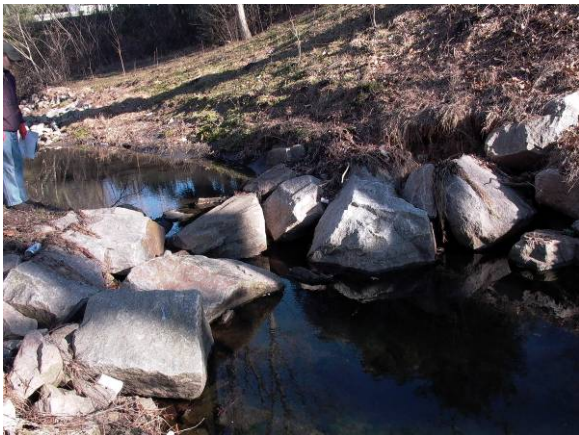
Issue Photo 1. Arm Scour left bank STA: 0+95, STA: 4+75 & STA 14+75
