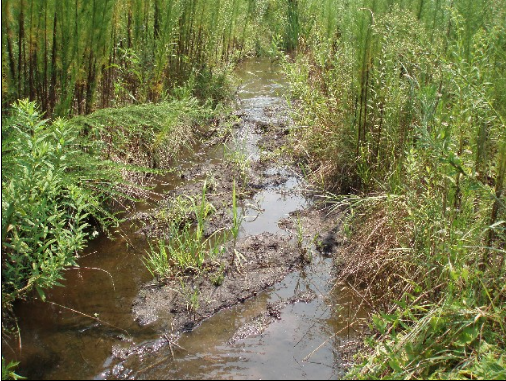
SPA #9. STA 55+90. bed erosion.
