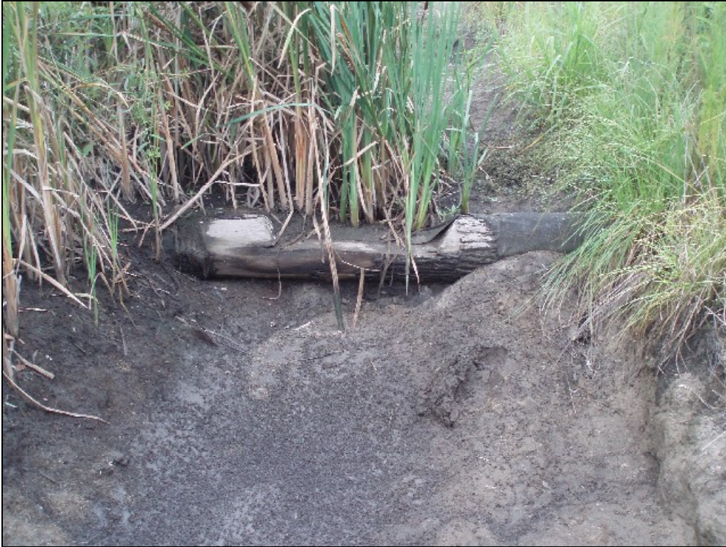
SPA #19. STA 76+90. Log weir undercut.
