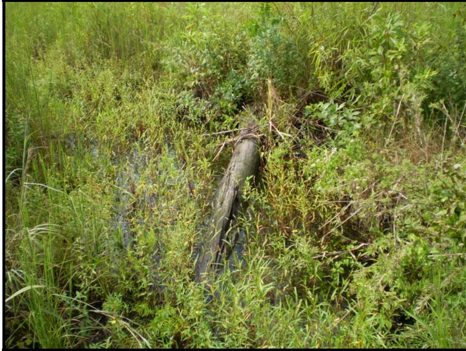
SPA 1. UT1-A Sta. 38+60 Log vane undercutting
