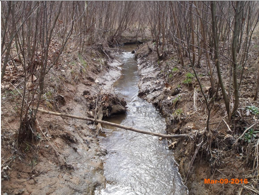
Reach 1 Sta. 314+00– Riffle Degradation
