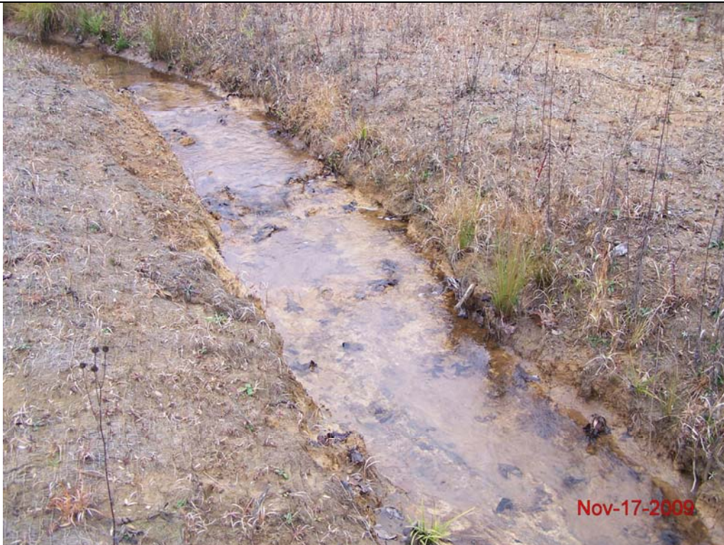
SPA14 UT6 Sta. 603+75 – Riffle Bed Scour
