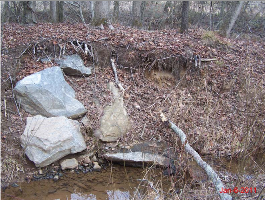
SPA8 UT5 Sta. 515+50 – Bank Scour
