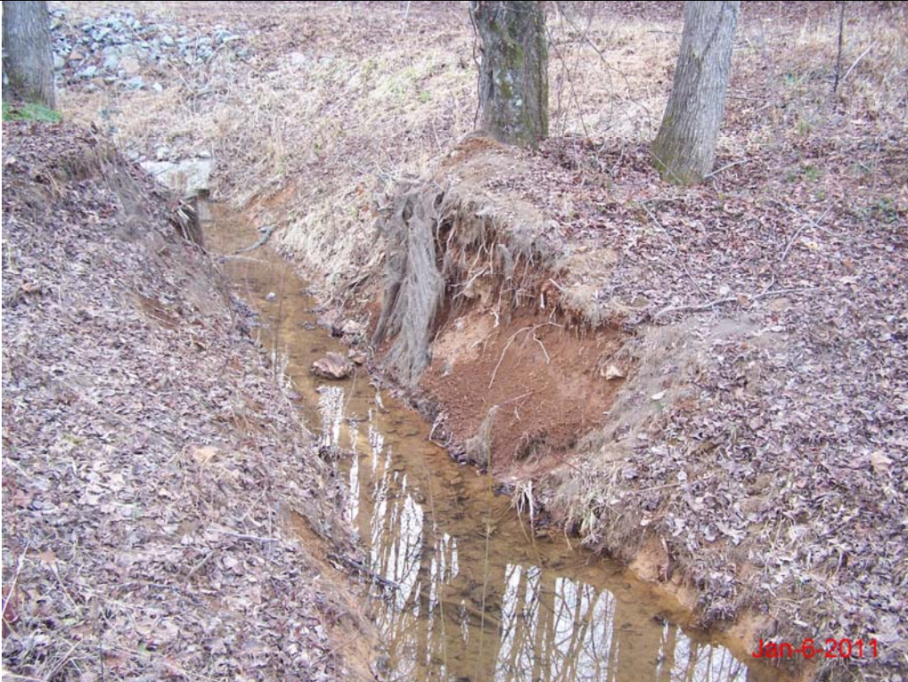
SPA7 UT5 Sta. 515+10 – Bank Scour
