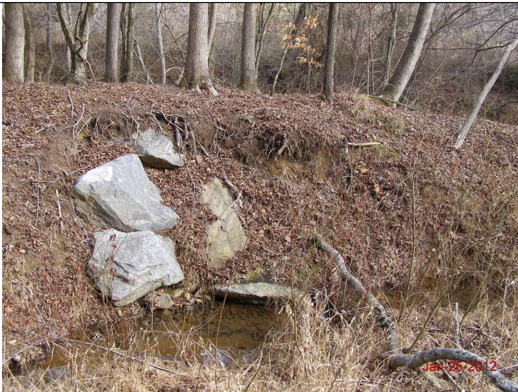
SPA8 UT5 Sta. 515+50 – Bank Scour
