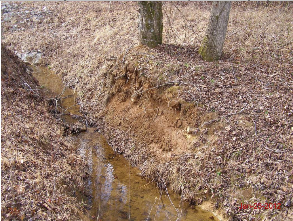
SPA7 UT5 Sta. 515+10 – Bank Scour
