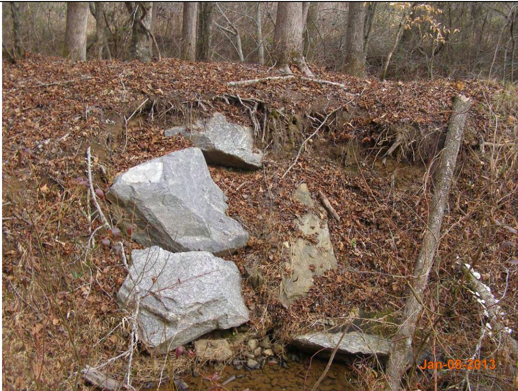
SPA8 UT5 Sta. 515+50 – Bank Scour
