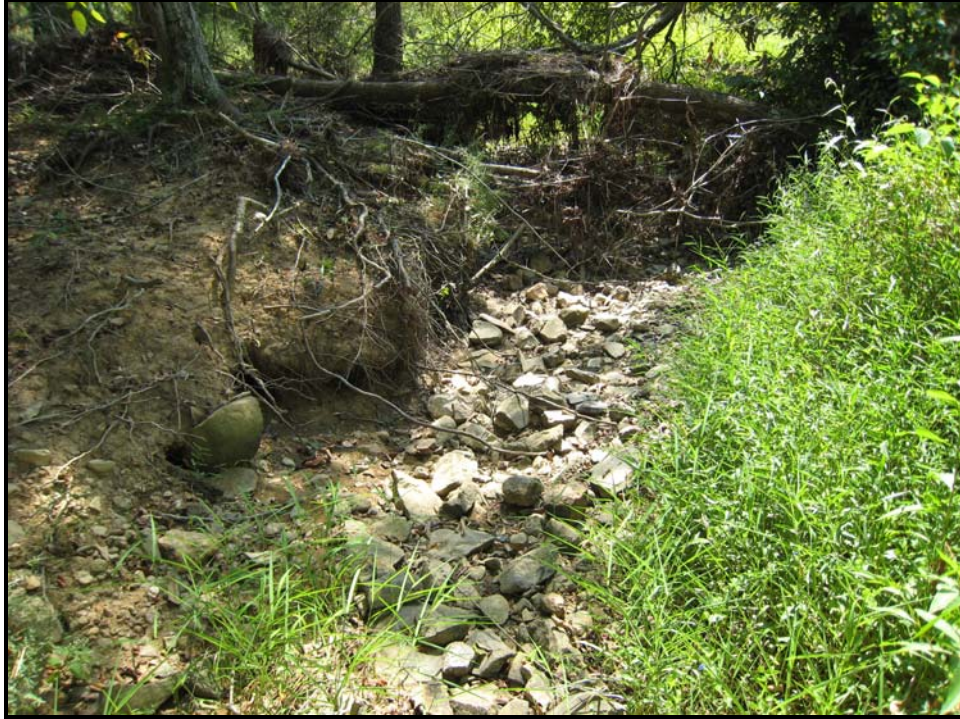
SPA # 3. Debris jam at Sta. 170+50.
