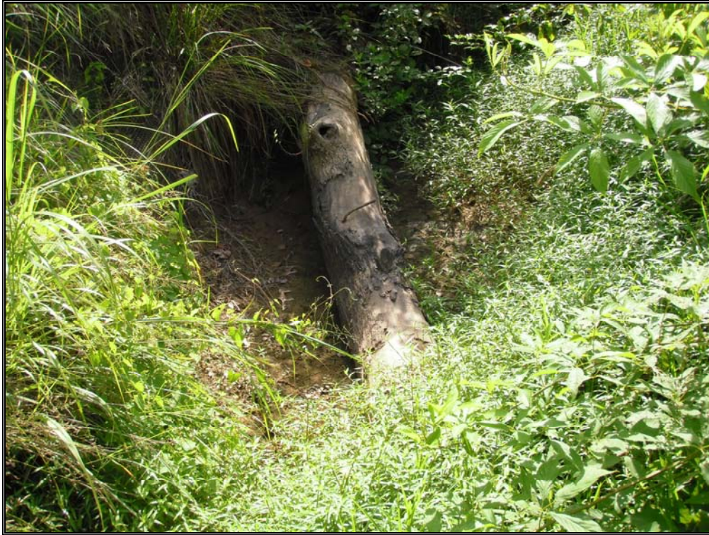
SOA 6– Log vane undercut., UT1, Sta. 11+00.
