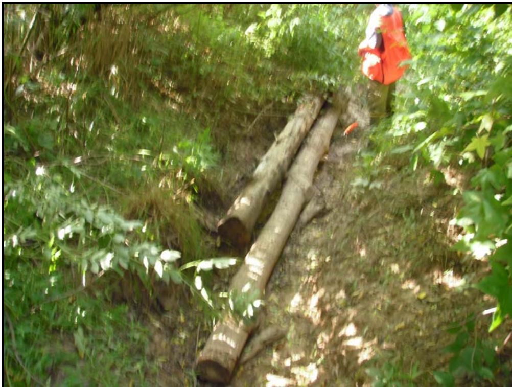
SOA 5 – Log vane undercut, UT1, Sta. 16+00.
