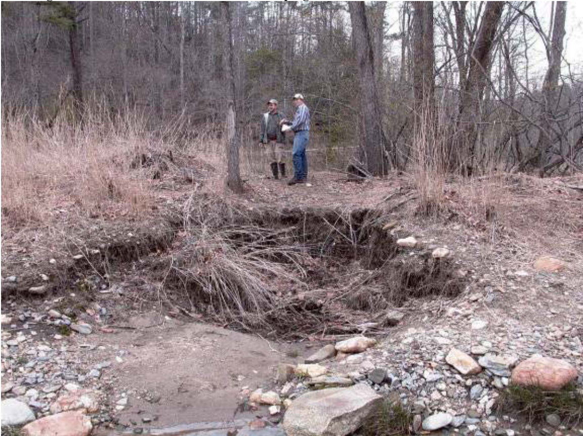
Right Bank Erosion STA ~ 13+10
