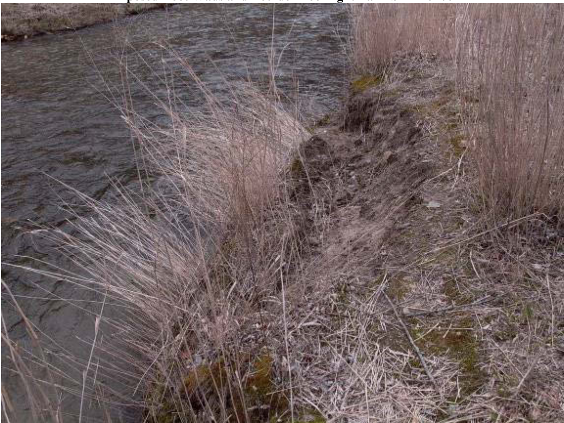
Right Bank Slump STA ~ 6+35
