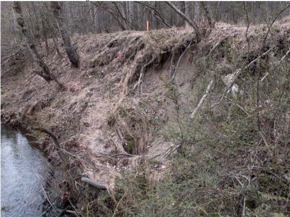
Right Bank Erosion STA ~ 6+50
