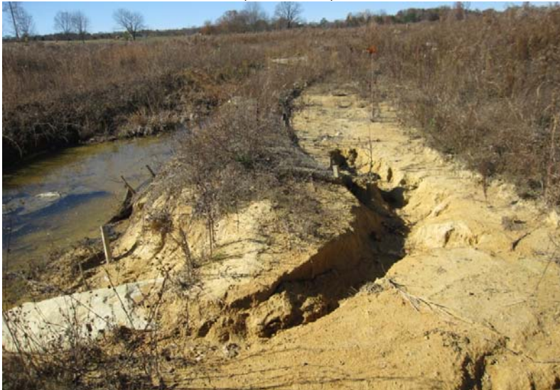
7. Bare Soil/Gully Formation (Sta. 34+70)
