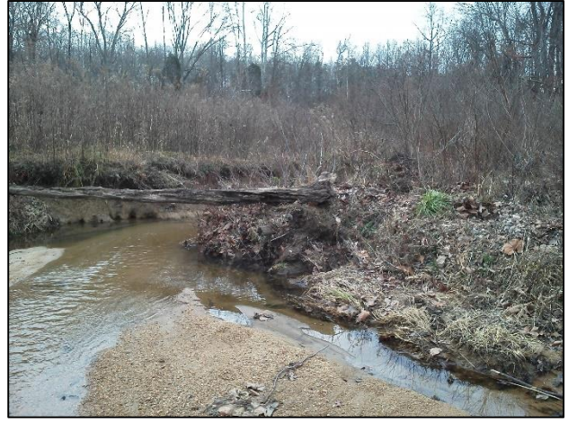
Thalweg shift (Station 84+00) – 12/18/2014
