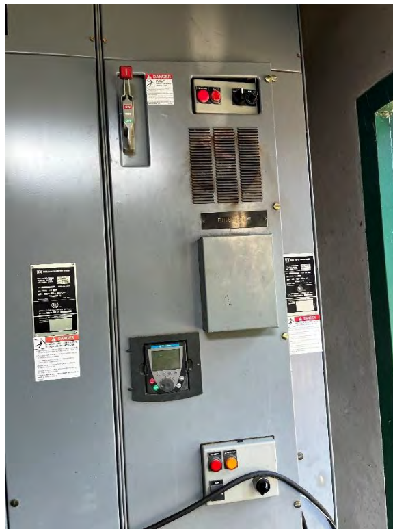
Effluent Pump Panel
